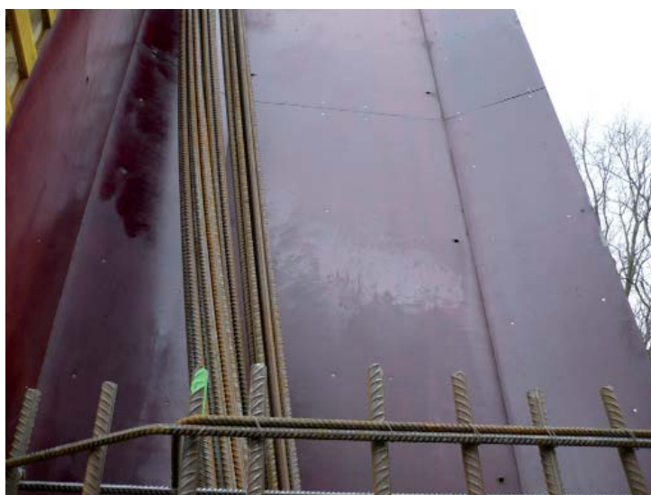
Patrné stékání přebytečného množství odbedňovacího oleje
